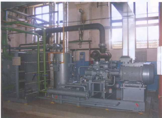
Водоохолоджувальна аміачна холодильна машина («Київмедпрепарат»)
